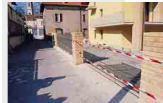
L'ingresso del cantiere: mancava ogni indicazione sui lavori
