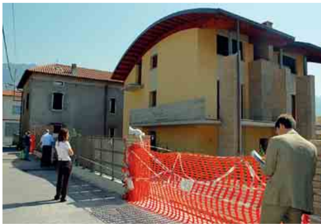
Il cantiere di via Magistris luogo della tragedia: Beatrice venne schiacciata da un pesantissimo cancello
