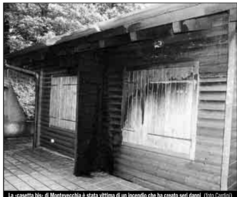
La «casetta bis» di Montevocchia è stata vittima di un incendio che ha creato seri danni. (foto Cardini)
